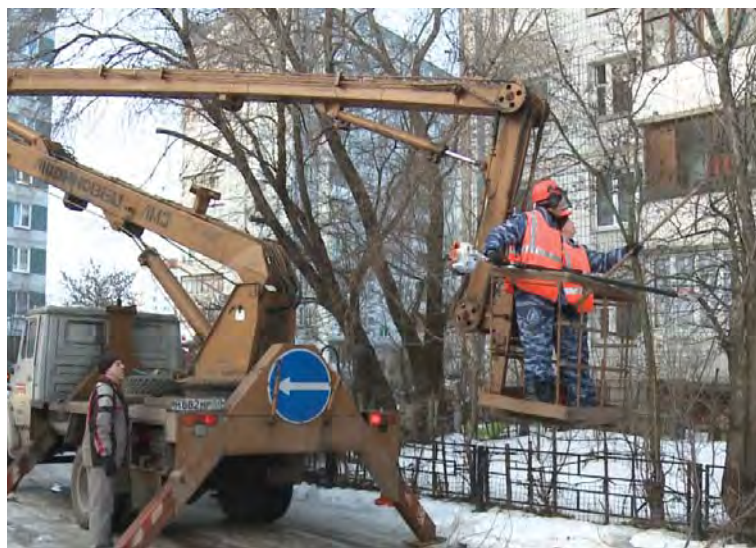
Сухое дерево возле дома на ул. Станционной, 1 спилили на этой неделе сотрудники «Спецремтранса»
