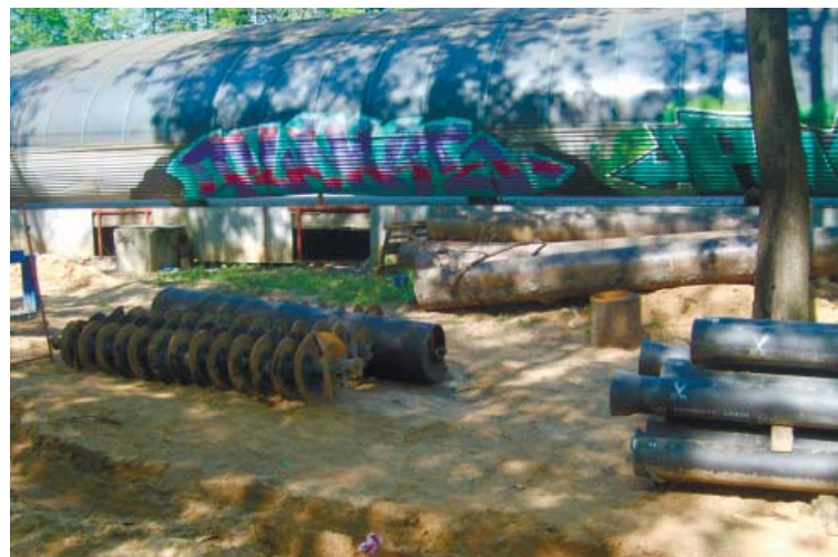
При реконструкции железной дороги от станции Перловской до станции Тайнинской допущены многочисленные нарушения
